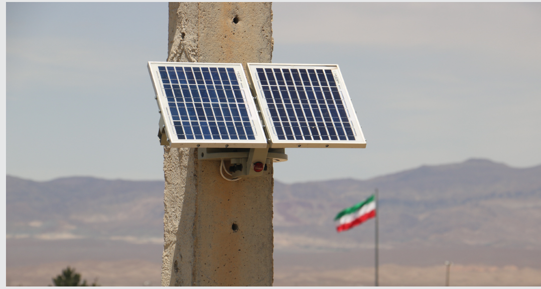
تصویر دستگاه نصب شده در محل تیر برق
